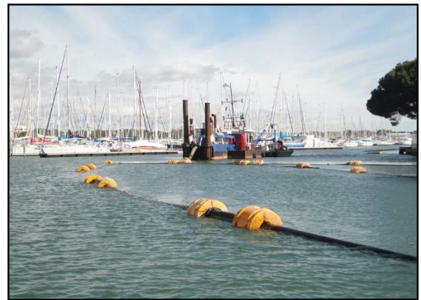
Figure 13 : Rejet par conduite (Régie autonome de Port Camargue, 2016)
