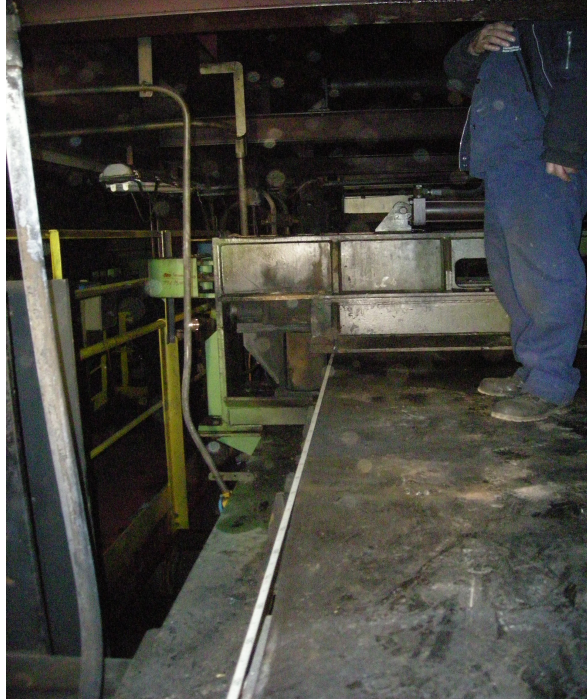
Foto2. Dettaglio della non corretta centratura della lamiera, Thyssenkrupp Torino
