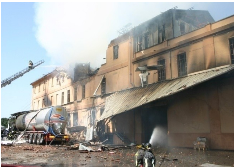
Foto 11. Edificio lato SUD con evidenti danni da sovrappressione interna e tetto disintegrato, Molino Cordero
